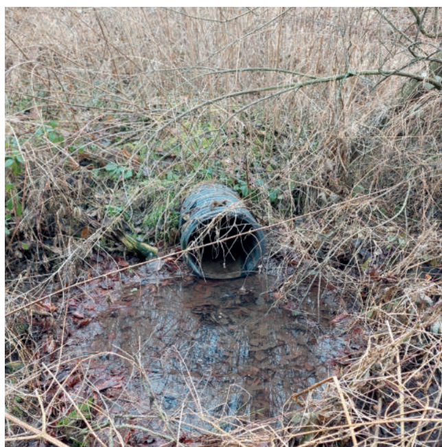
Résurgence au sud-est du site, sortant d'un tuyau, AVIS VERT, 2025
